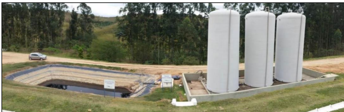
Figura 50. Área de armazenamento de líquido percolado (chorume) da empresa VSA.
