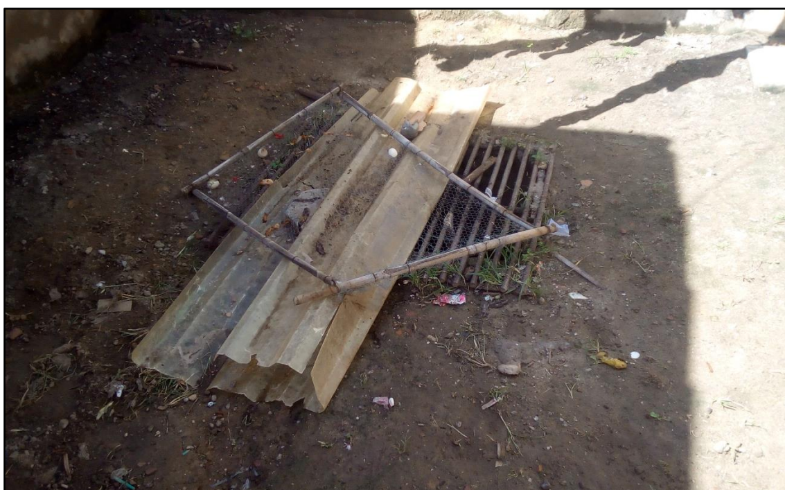
Figura 108. Saída de água da chuva do "Beco do Izalino" em Canas (SP).
